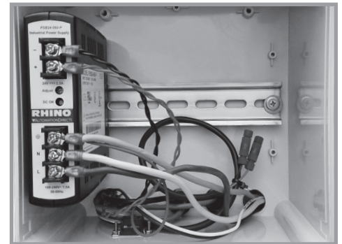
Emplacement des fils de connexion de l'interrupteur à flotteur du boîtier de commande.
